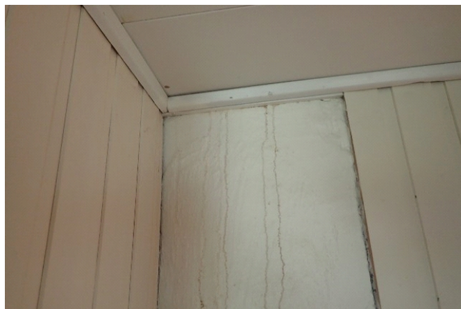
Merker etter musepiss på yttervegg i stue.
