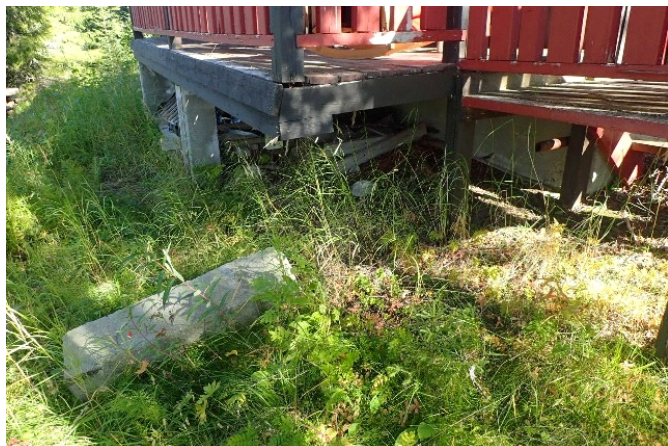
Støpt pilar som har ramlet ned under hjørne på veranda.
