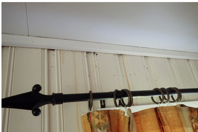
Merker etter musepiss på yttervegg i stue.
